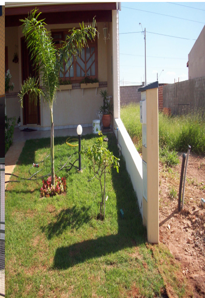
Pedestal lateral entrada BT subterrânea
