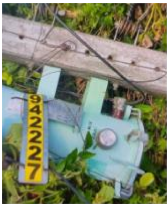
Figura 26 - Evidência de Campo Norte, Município de Mariano Moro - Fonte: RGE
