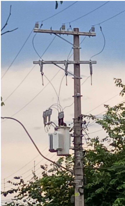
Figura 49- Evidência de Campo Vale dos Sinos, Município de Campo Bom - Fonte: RGE
