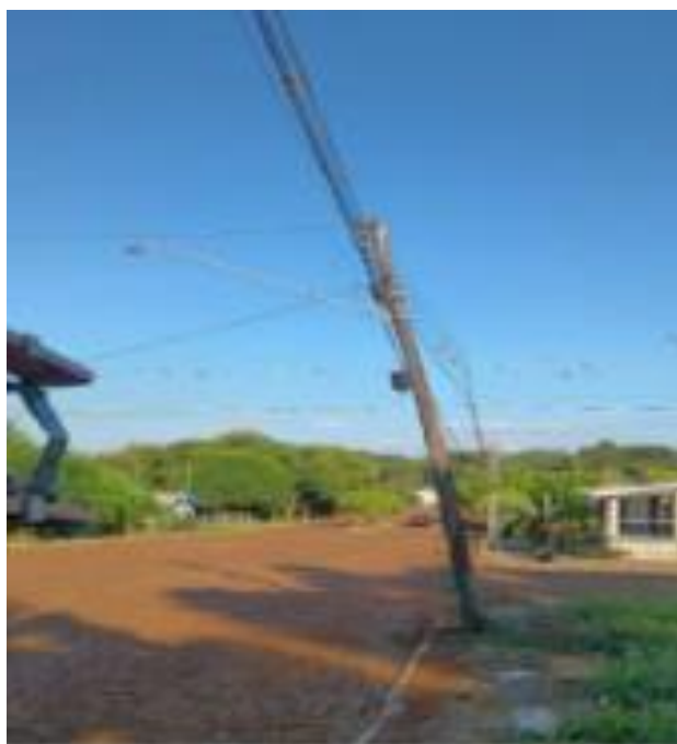
Figura 28- Evidência de Campo Norte, Município de Erebangó - Fonte: RGE
