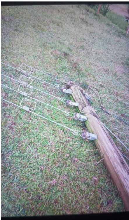
Figura 54 - Evidência de Campo Vale do Taquari, Município de Farroupilha - Fonte: RGE
