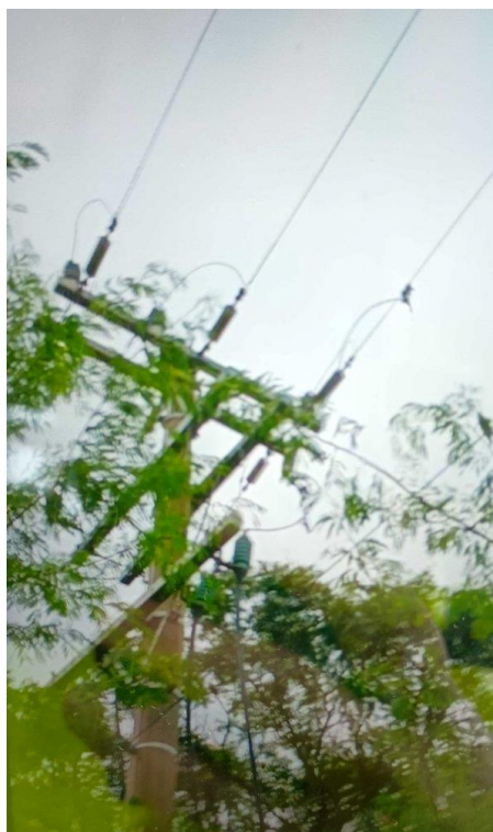
Figura 50- Evidência de Campo Pampas, Município de Alegrete - Fonte: RGE
