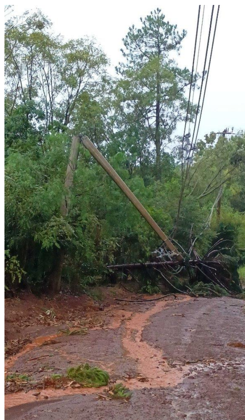
Figura 59 - Evidência de Campo Norte, Município de Santa Rosa - Fonte: RGE
