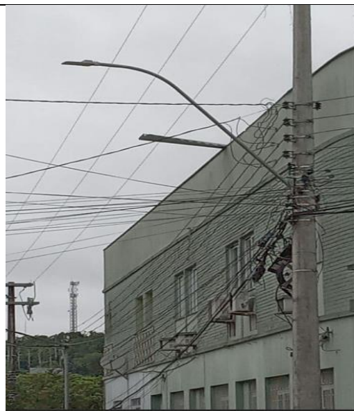
Figura 67 - Evidência de Campo da Região da Vale do Rio Pardo, Estação Avançada de Sobradinho, Município Sobradinho - Fonte: RGE
