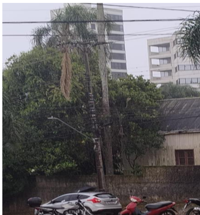
Figura 108 - Evidência de Campo da Região Planalto, Estação Avançada de Erechim- Fonte: RGE
