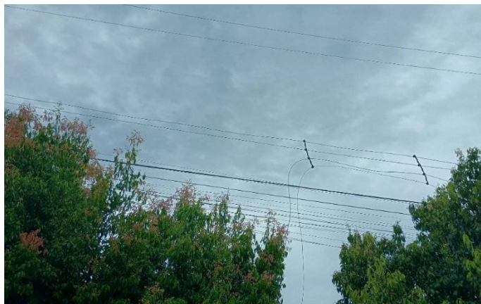
Figura 96 - Evidência de Campo da Região Missões, Estação Avançada de Santiago- Fonte: RGE
