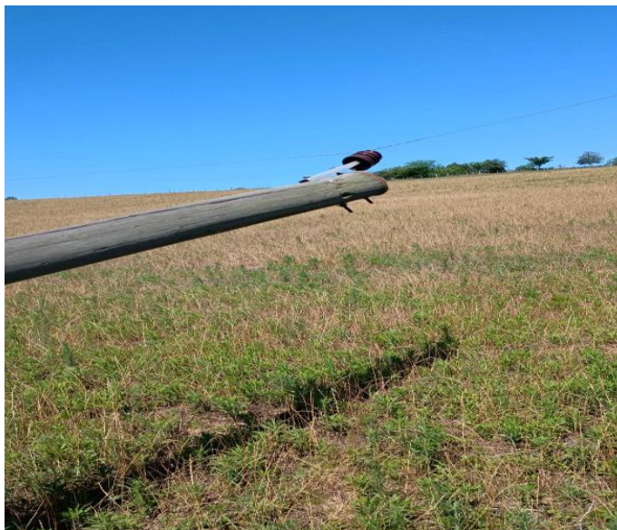
Figura 136 - Evidência de Campo da Região Central, Estação Avançada de São Pedro do Sul- Fonte: RGE
