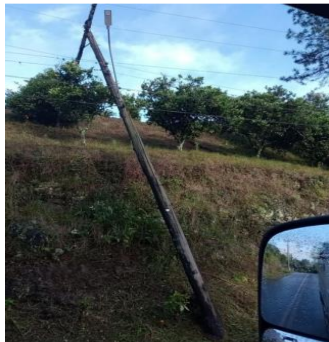
Figura 54 - Evidência de Campo da Região da Serra, Estação Avançada de Caxias do Sul - Fonte: RGE
