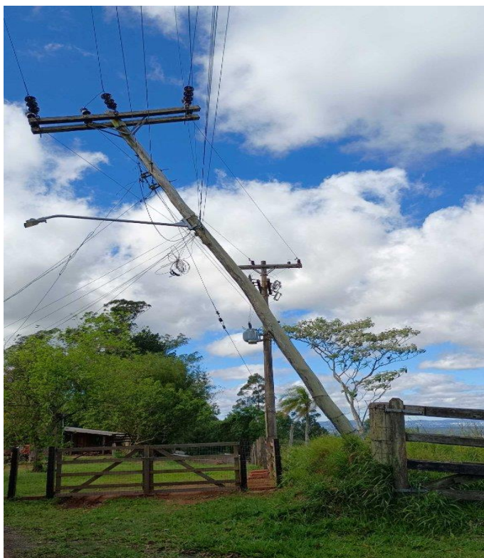
Figura 128 - Evidência de Campo da Região Canoas, Estação Avançada de Sapucaia do Sul- Fonte: RGE
