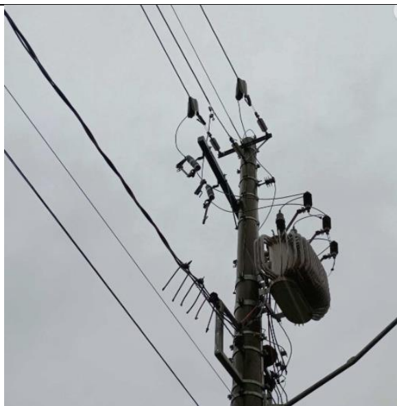
Figura 66 - Evidência de Campo da Região da Vale do Rio Pardo, Estação Avançada de Sobradinho, Município Sobradinho - Fonte: RGE
