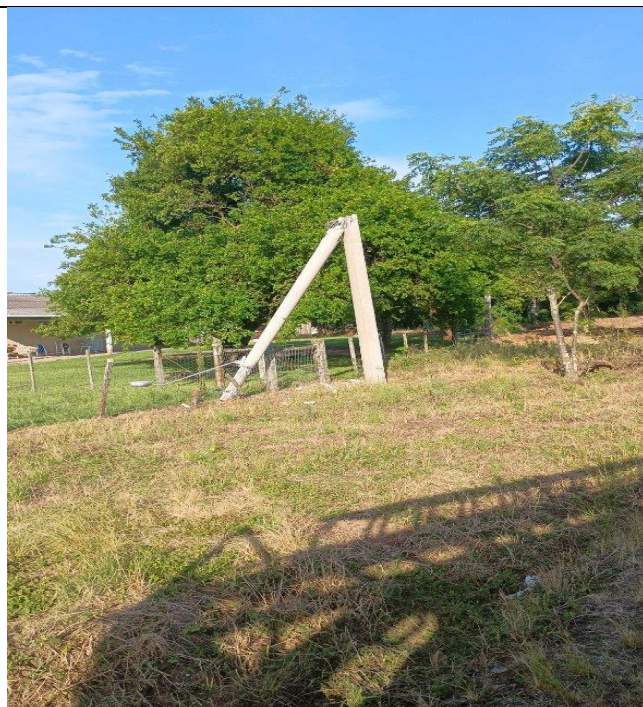
Figura 95 - Evidência de Campo da Região Missões, Estação Avançada de Santiago- Fonte: RGE
