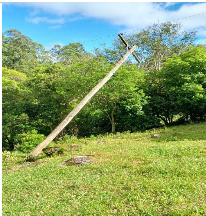
Figura 178 - Evidência de Campo da Região Serra, Estação Avançada de Antônio Prado- Fonte: RGE
