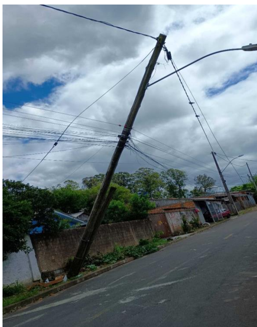
Figura 32 - Evidência de Campo da Região de Canoas, Município Canoas - Fonte: RGE
