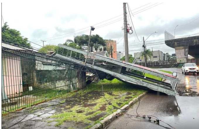
Figura 28 - Evidência de Campo da Região de Canoas, Município Canoas - Fonte: RGE
