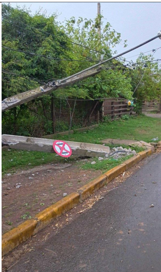
Figura 38 - Evidência de Campo da Região de Canoas, Município Canoas - Fonte: RGE
