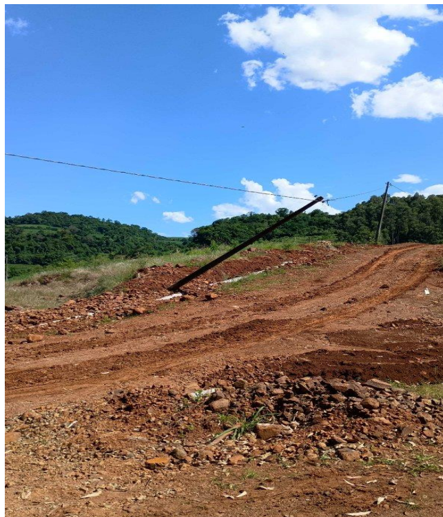
Figura 133 - Evidência de Campo da Região Norte, Estação Avançada de Constantina- Fonte: RGE
