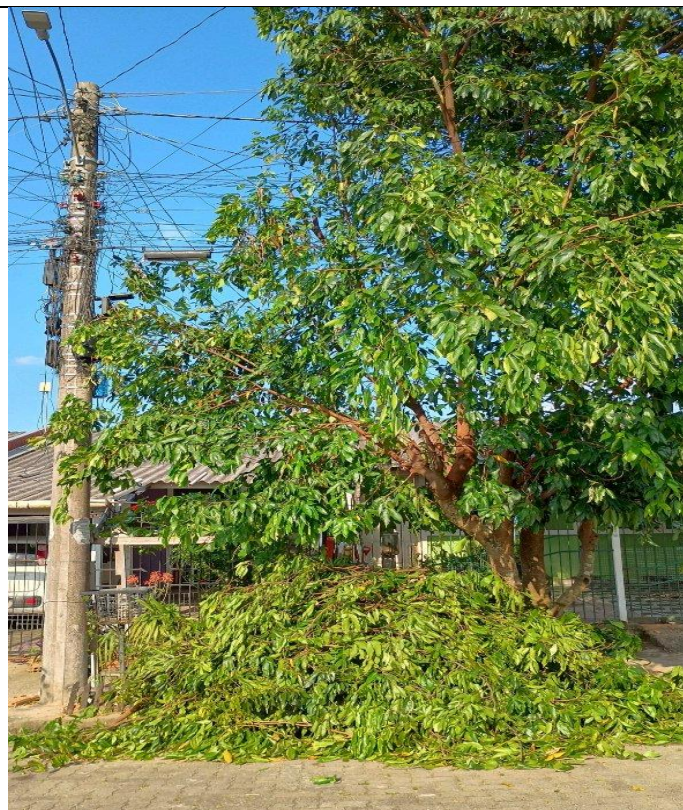
Figura 122 - Evidência de Campo da Região Canoas, Estação Avançada de Sapucaia do Sul- Fonte: RGE
