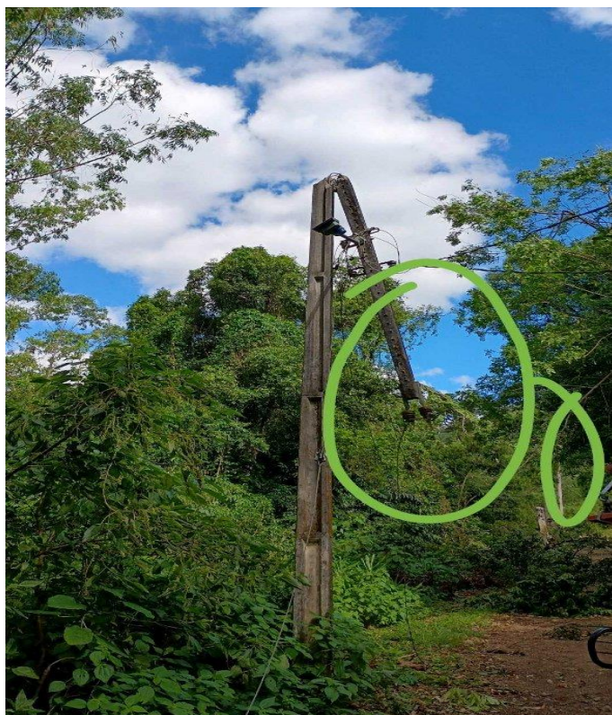
Figura 156 - Evidência de Campo da Região Vale dos Sinos, Estação Avançada de Taquara Fonte: RGE
