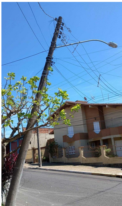
Figura 36 - Evidência de Campo da Região de Canoas, Município Canoas - Fonte: RGE
