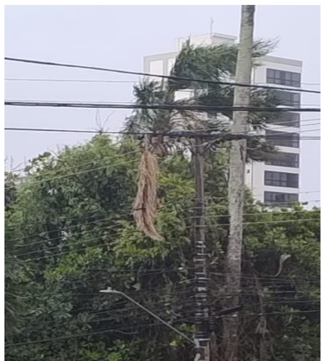
Figura 110 - Evidência de Campo da Região Planalto, Estação Avançada de Erechim- Fonte: RGE
