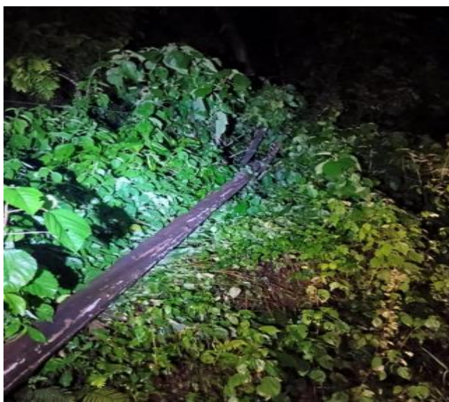
Figura 53 - Evidência de Campo da Região da Serra, Estação Avançada de Caxias do Sul - Fonte: RGE
