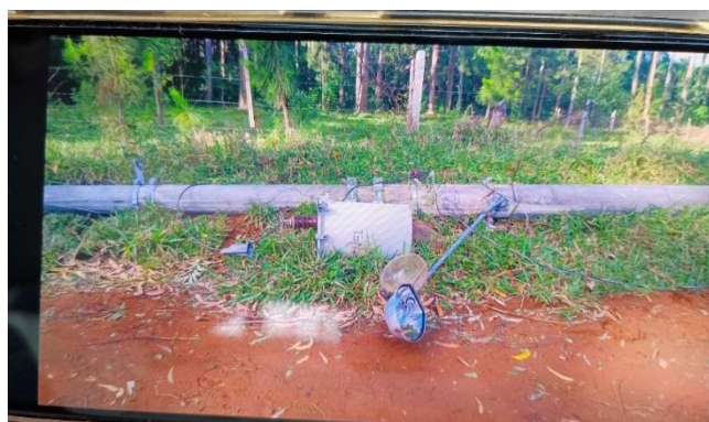
Figura 169 - Evidência de Campo da Região Vale dos Sinos, Estação Avançada de Taquara - Fonte: RGE
