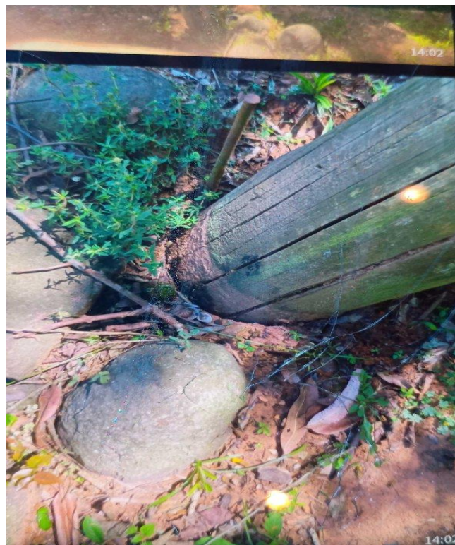
Figura 127 - Evidência de Campo da Região Canoas, Estação Avançada de Sapucaia do Sul- Fonte: RGE
