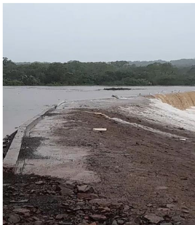
Figura 77 - Evidência de Campo da Região Pampas, Estação Avançada de Santana do Livramento - Fonte: RGE
