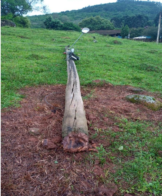
Figura 188 - Evidência de Campo da Região Serra, Estação Avançada de Gramado- Fonte: RGE
