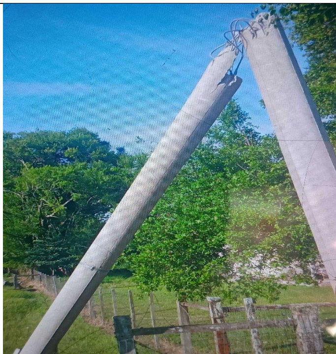
Figura 94- Evidência de Campo da Região Missões, Estação Avançada de Santiago- Fonte: RGE
