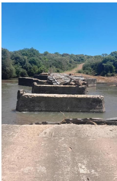
Figura 72 - Evidência de Campo da Região Pampas, Estação Avançada de Santana do Livramento - Fonte: RGE
