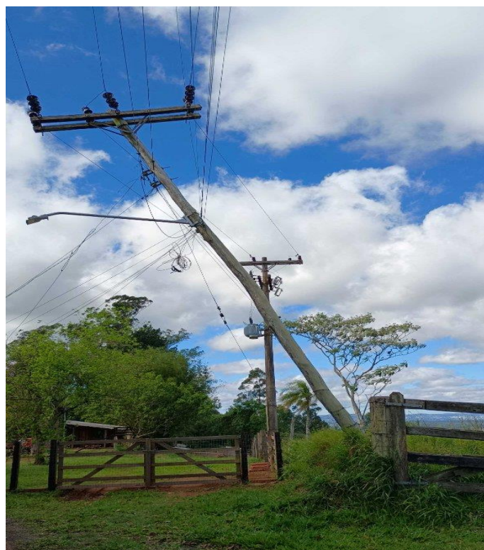
Figura 172 - Evidência de Campo da Região Canoas, Estação Avançada de Sapucaia do Sul - Fonte: RGE
