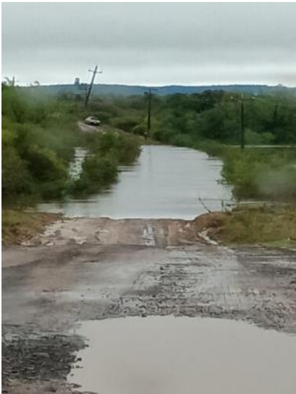
Figura 36 - Evidência de Campo do Central, Estrada do Farrapo, Rosário do Sul - Fonte: RGE
