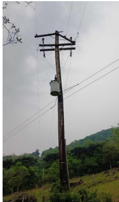
Figura 67 - Evidência de Campo Serra, Ana Rech - Fonte: RGE
