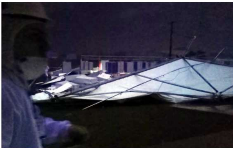
Feridos no desabamento de um telhado na JBS Trindade do Sul foram socorridos. Foto: TV Trindade
