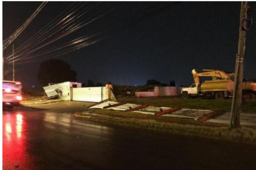
Vendaval derrubou tapumes em canteiro de obras no Desvó Rizzo Cristiano Daros / Agência RBS
