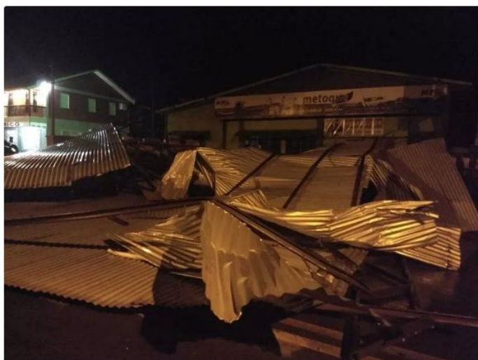
Destelhamento ocorrido na cidade de Não-Me-toque (Foto: Portal NMT)
