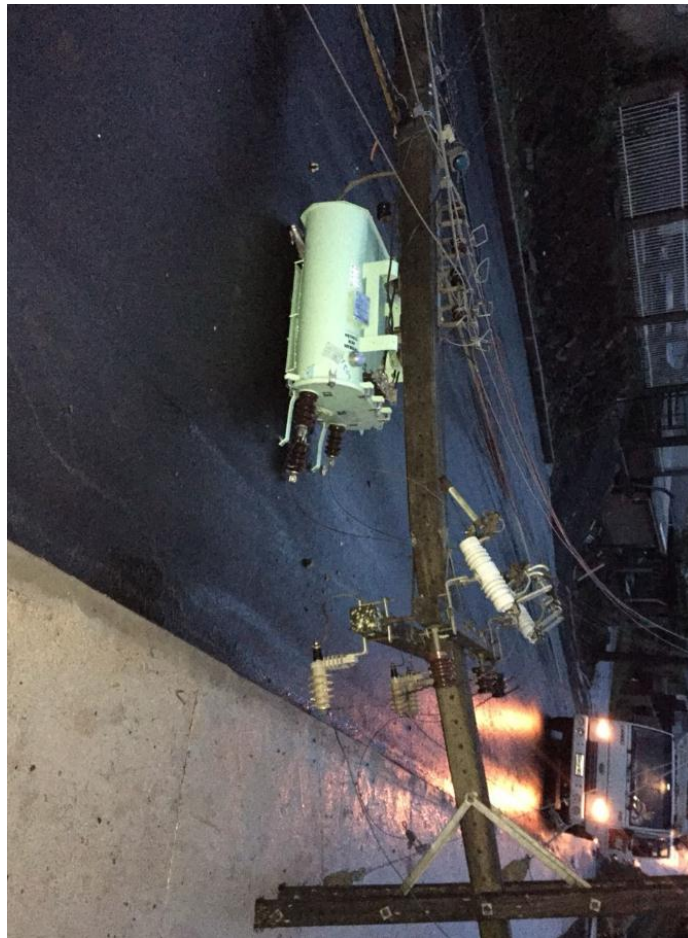
Figura 21 - Evidência Fotográfica – Região Centro – Área Urbana
