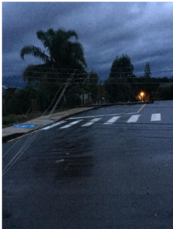
Figura 20 - Evidência Fotográfica – Região Centro – Área Urbana
